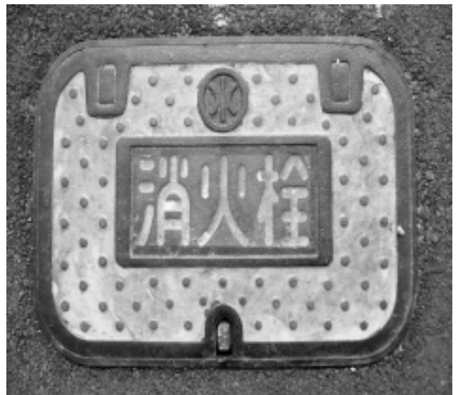
地 下 式 消 火 栓
