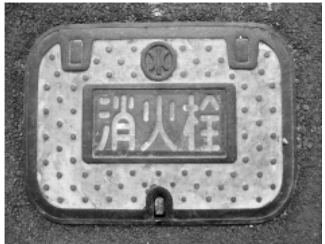
地下式消火栓
