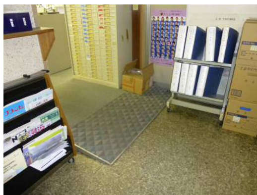
執務スペースと廊下の段差
