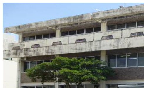
外壁面の劣化
