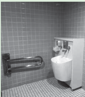
▲オストメイト対応トイレ (文化プラザ)
