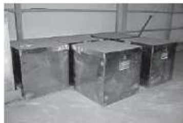
▲保管されているPCB使用機器
