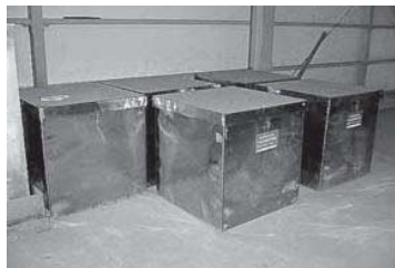
▲保管されているPCB使用機器
