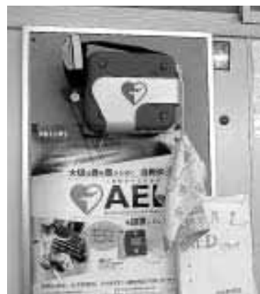
▲土岐津中学校に設置されたAED
