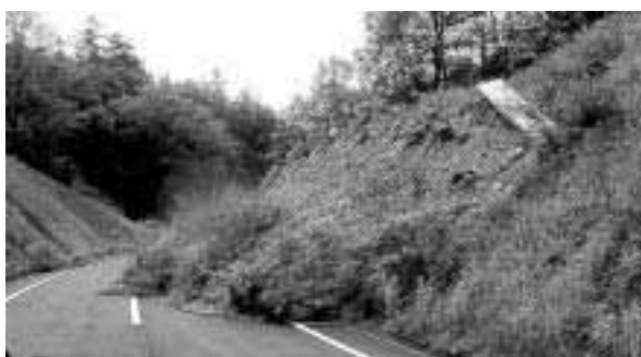
崩落した荒神洞線
