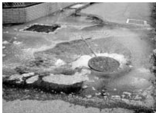
汚水があふれ出ている様子
