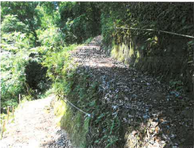
危険箇所 施工前
