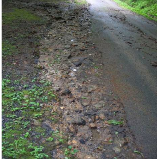
濁流に削られた参道の未舗装部分
