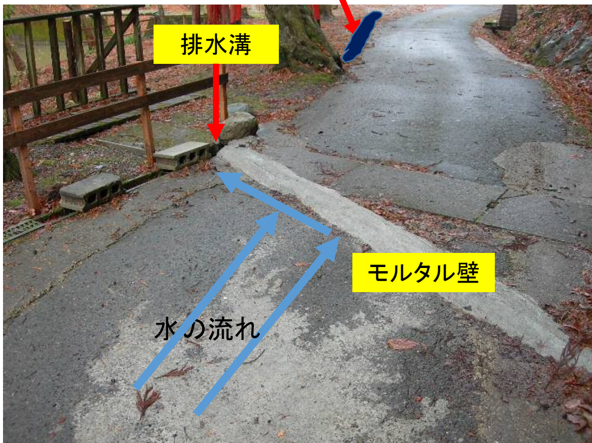
モルタル壁で水を排水溝へ導入
