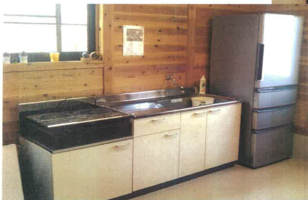
厨房設備 全体写真
