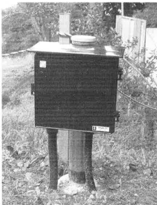
延長コード接続ポスト(15個設置)
