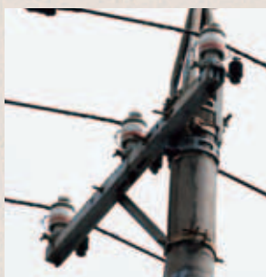
電柱で使われている碇子
