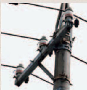
電柱で使われている碇子
